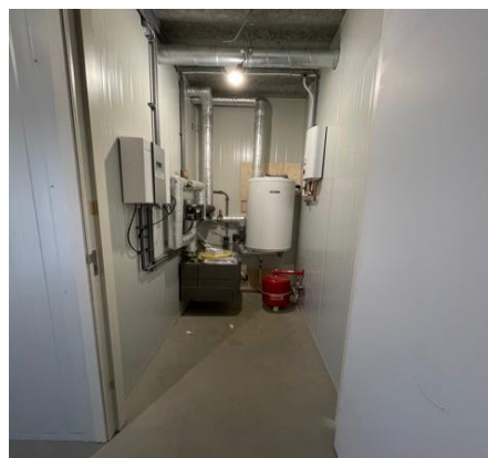
technische ruimte met warmtepomp
